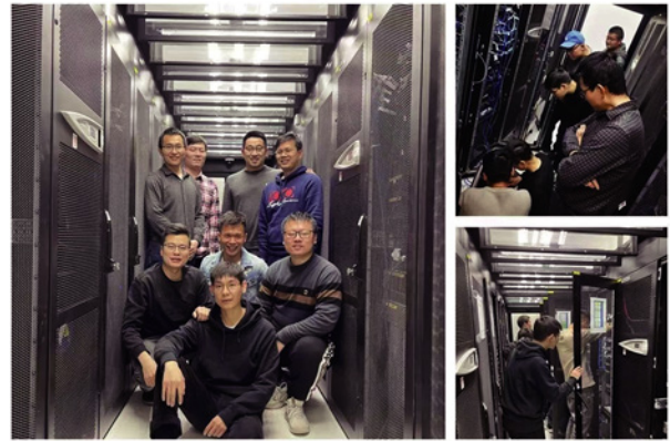
2023年2月，公司IDC机房搬迁工作顺利完成
